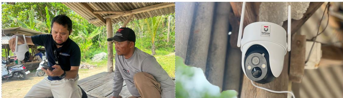
Gambar 3. Tim menjelaskan cara kerja CCTV dan CCTV yang sudah terpasang.
